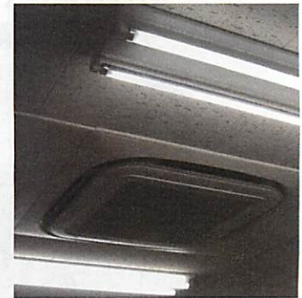
更新した照明・空調設備
