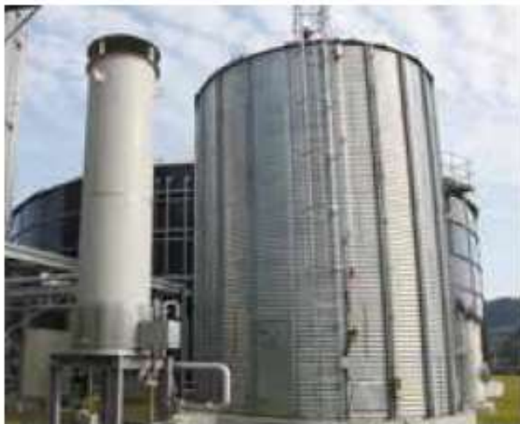
ガスホルダ・余剰ガス燃焼装置
