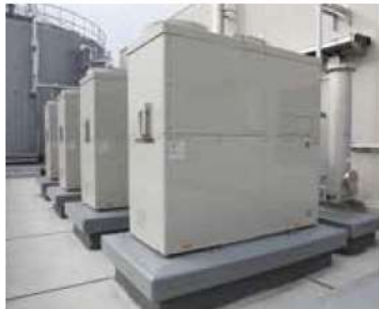
バイオガス発電機
